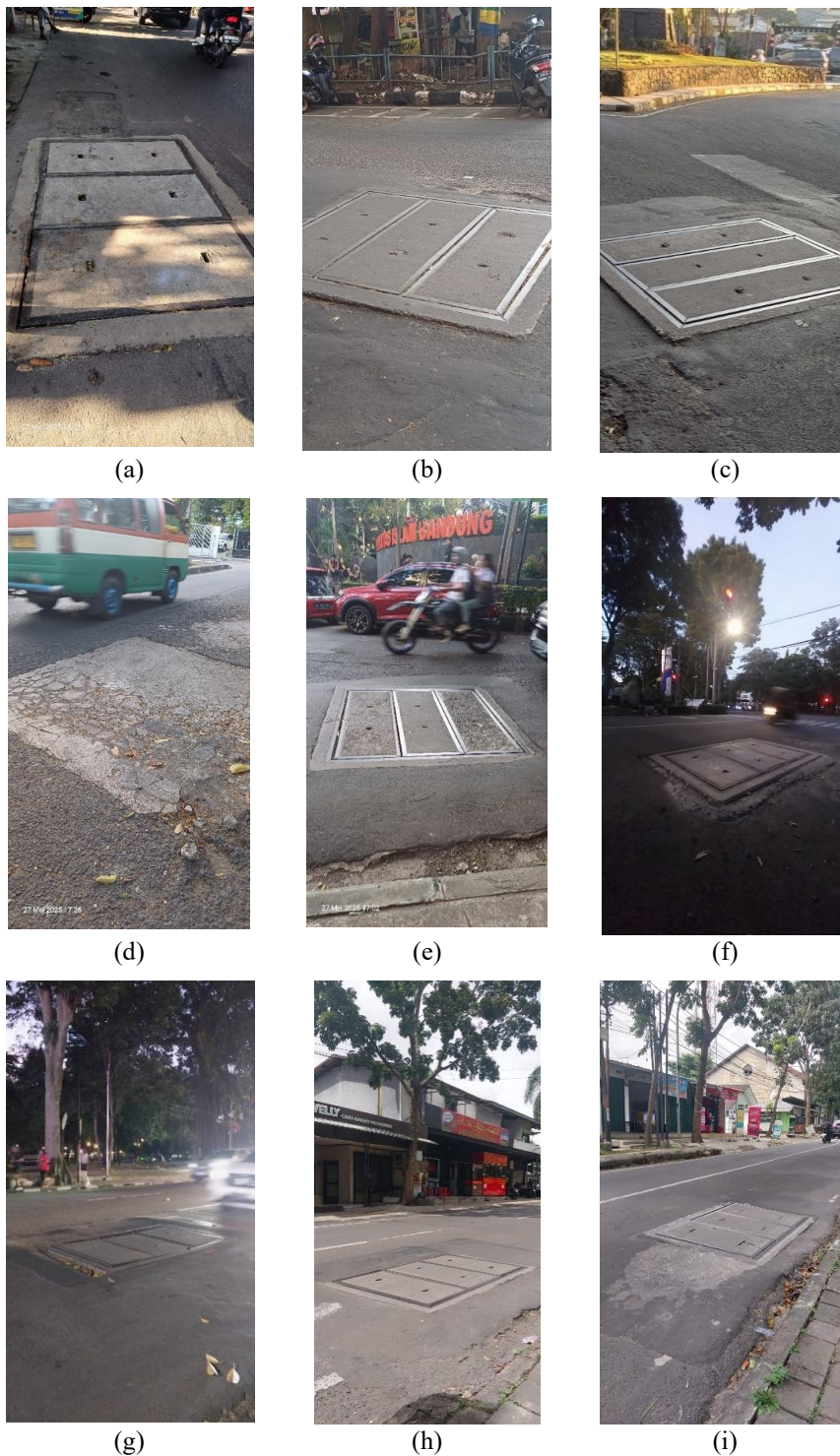
Gambar 4. Kondisi Manhole dengan Kategori Kurang (a) Objek A1; (b) Objek A2; (c) Objek A3; (d) Objek B3; (e) Objek E2; (f) Objek F6; (g) Objek G1; (h) Objek N2; (i) Objek N6
