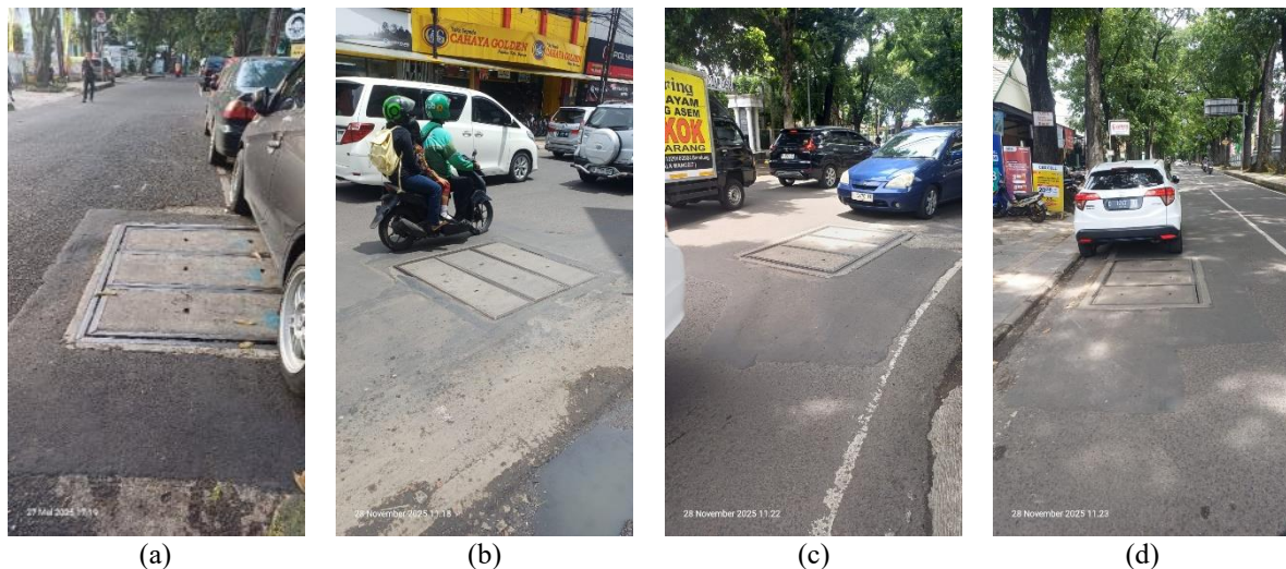
Gambar 3. Kondisi Manhole dengan Kategori Baik (a) Objek B1; (b) Objek I2; (c) Objek M3; (d) Objek N1
